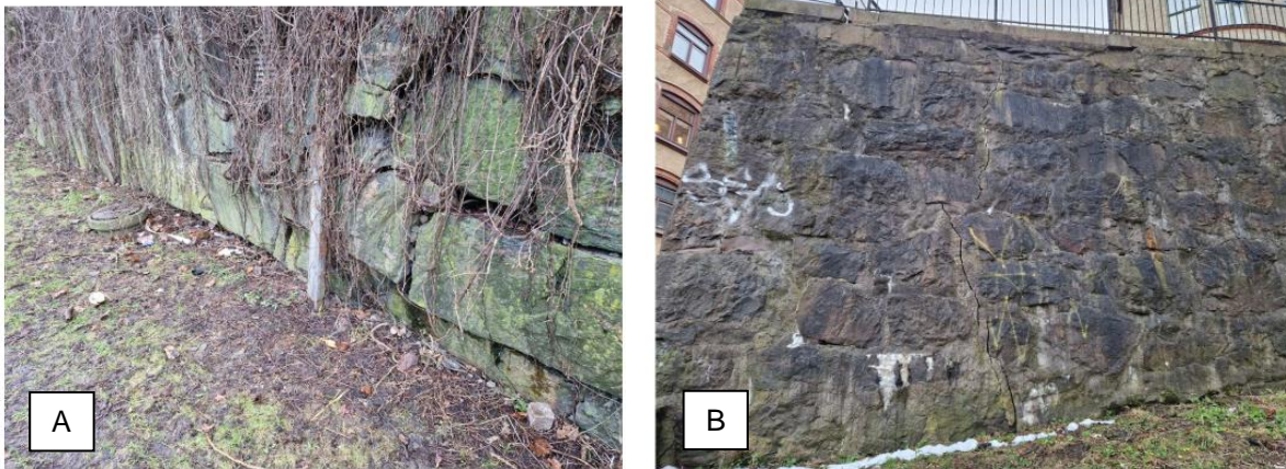
Figur 4. Bild på deformerad och blockutfall i stenmur öster ut mot Skanstorget (A) och bild på spricka i stenmur riktning sydväst mot Skansberget (B) (Norconsult, 2023).
